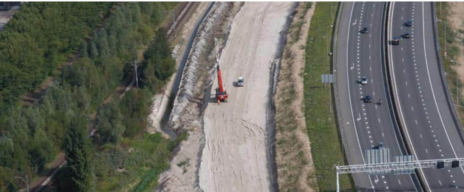
Строительство инфраструктуры при помощи вертикального дренажа на проекте строительства второго туннеля "Coentunnel", Амстердам
